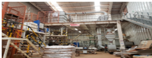
Fotografía 11. Área del extractor de Polvos Hosokawa
